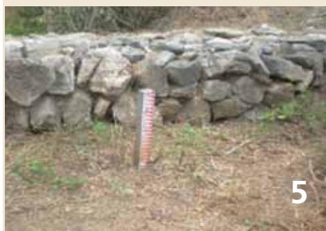
Foto 5 – Instalação da régua a montante do microbarramento para medir o volume de sedimentos.
